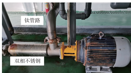
图 8 南部海域某岛海水淡化装置能量回收装置进出口管路运行 8 年后情况
