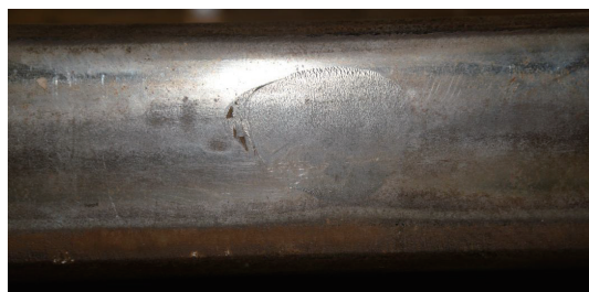
图1 钢轨伤损宏观形貌
